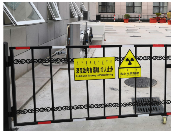
衰变池外设置的栏杆、警示标志
